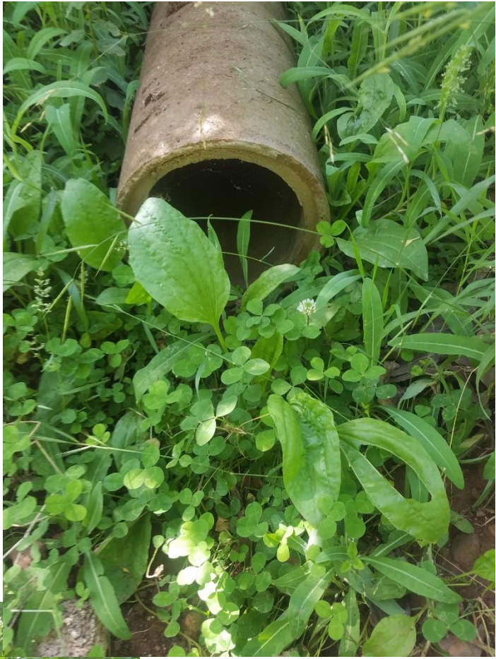
Figure 51 : Canal de circulation d'eau utilisé pour l'irrigation [P1].
