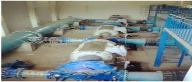
Photos 11 : La station de pompage numéro 1
