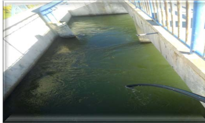
Photos 19 : Le bassin de coagulation
