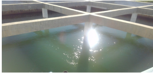
Photos 12 : le réservoir d'eau brute
