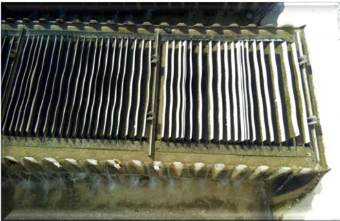
Photos 21 : Décantation lamellaire
