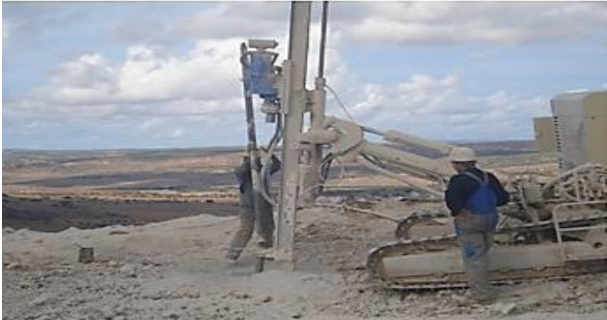
Figure 9 : Photo montrant un chariot de foration de type TITON entrain de creuser un trou
