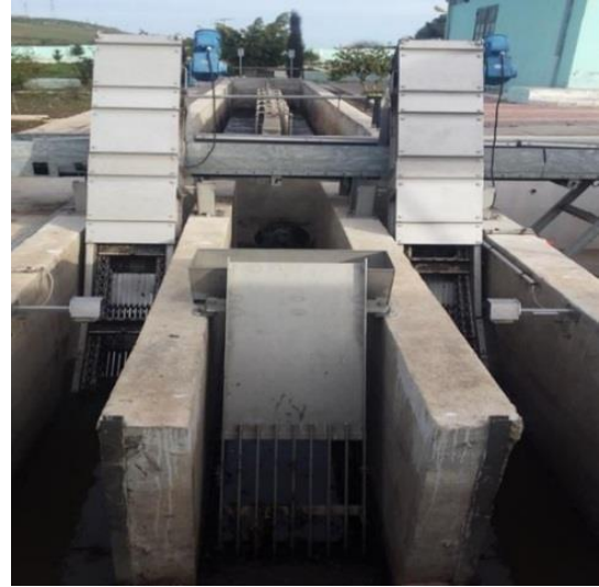
I2 : Un dégrilleur
