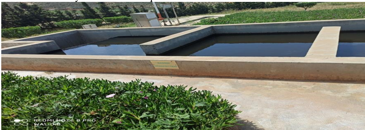
III10 : Bassin de désinfection
