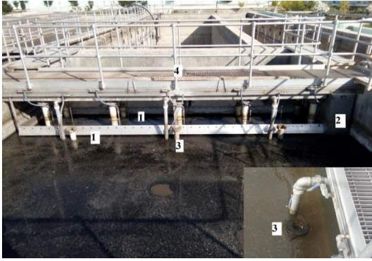
I7: Bassin de clarification (clarificateur)
