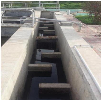
I5 ; Un bassin de désinfection
