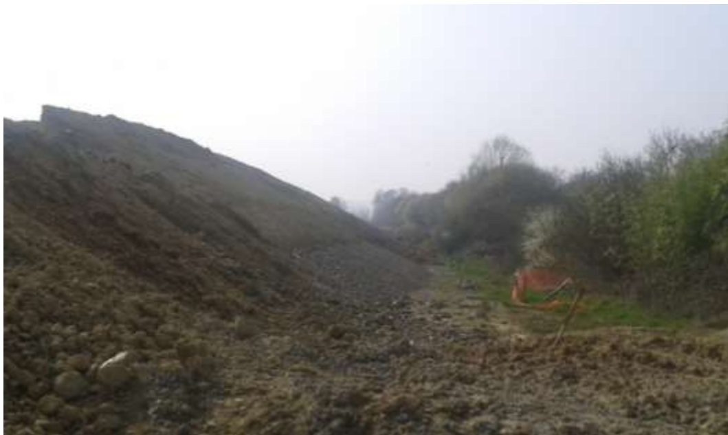
Fig 3. 3 : Borne de mesure profilométrique de remblai
