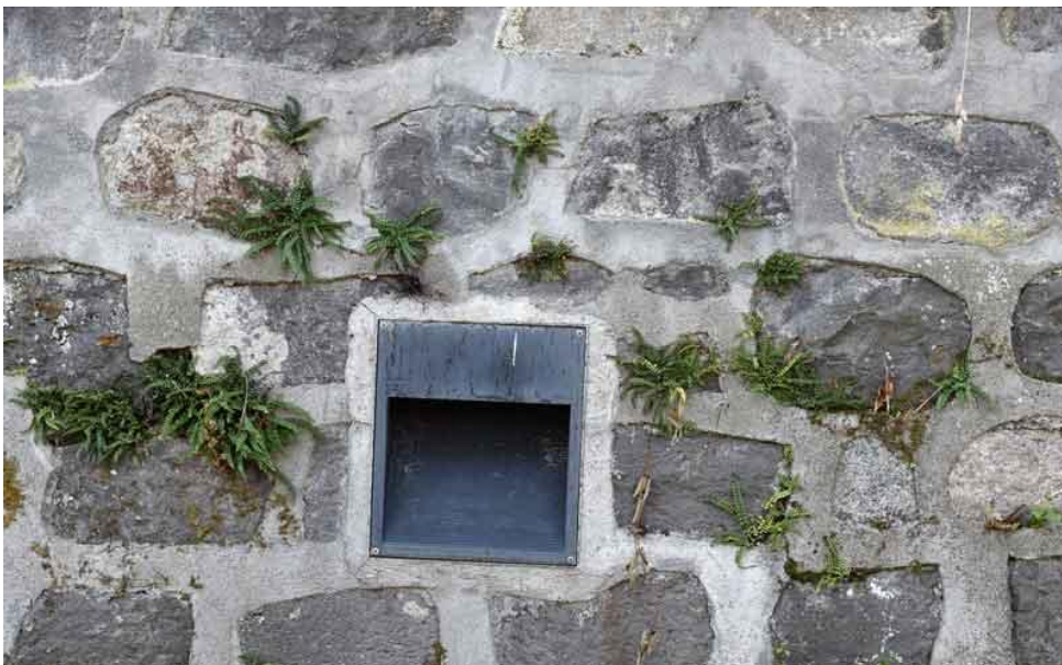
Figure 3: Les fougères profitent des moindres fissures ou discontinuités
