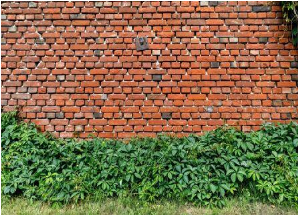
Figure 2: Mur en brique recouvert de feuilles
