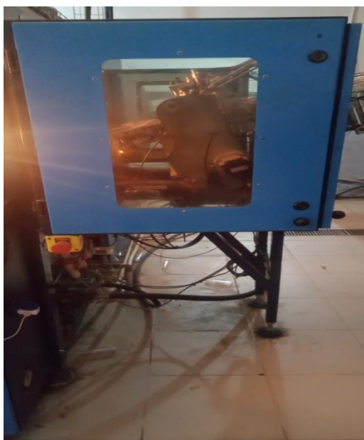
Figure 30: Les câbles sont mal rangés et poussiéreux
