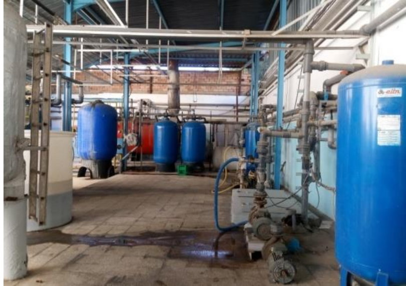
Figure 9: Station de traitement d'eau
