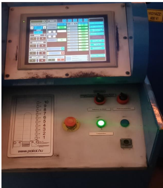
Figure 28: la poussière sur la commande de la soufflante
