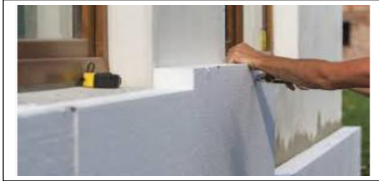
Figure 7.6 :L'isolation thermique par l'extérieur des façades ventilées
