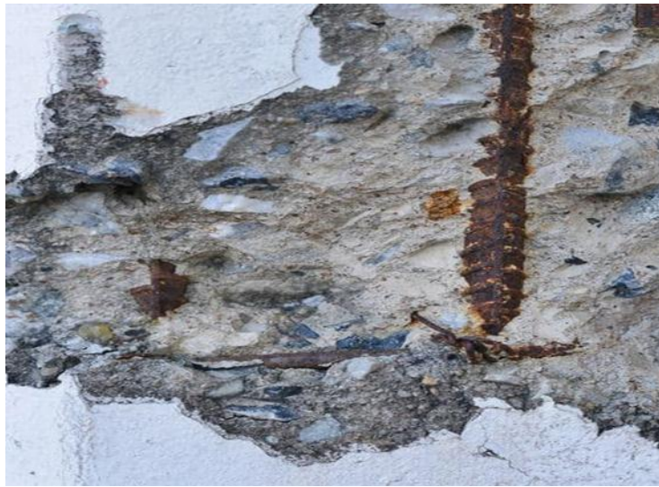
Figure 2.17 : Éclatement du béton d'enrobage à cause de la carbonatation [28].
