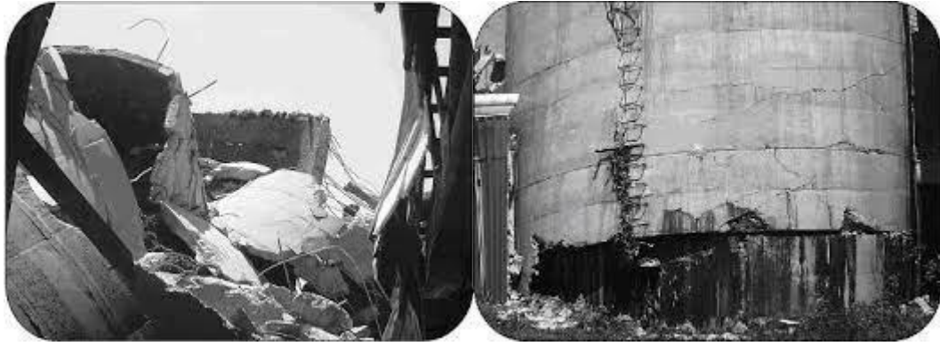
Figure 2.19 : La détérioration des silos-tours en béton due à l'attaque des acides d'ensilage [38].
