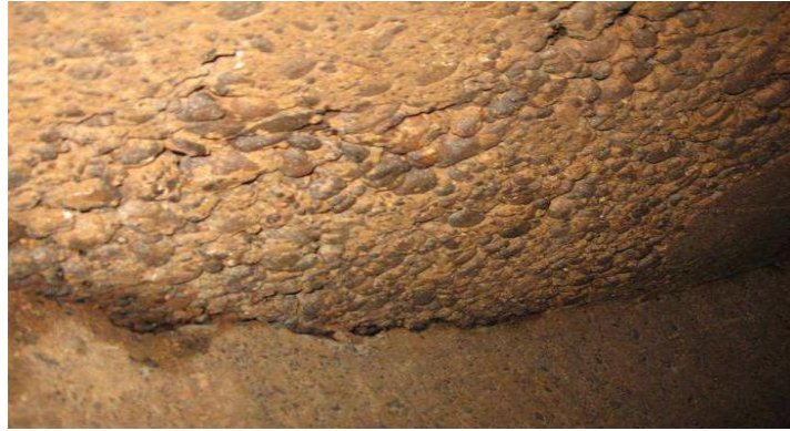
Figure 2.15 : Aspect d'une surface en béton ayant été soumise au phénomène de lixiviation [39].
