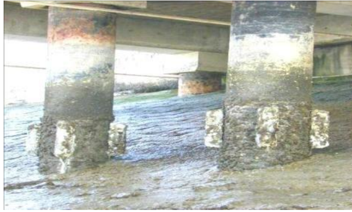
Figure 2.18 : Dégradations causées par les attaques sulfatiques [28].
