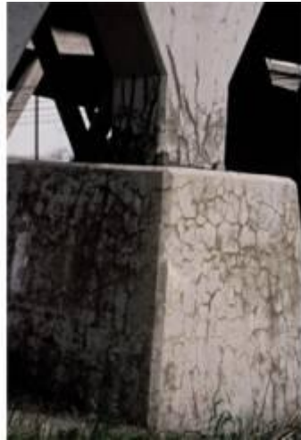
Figure 2.13 : Ouvrage atteint de réaction alcali-silice [31].
