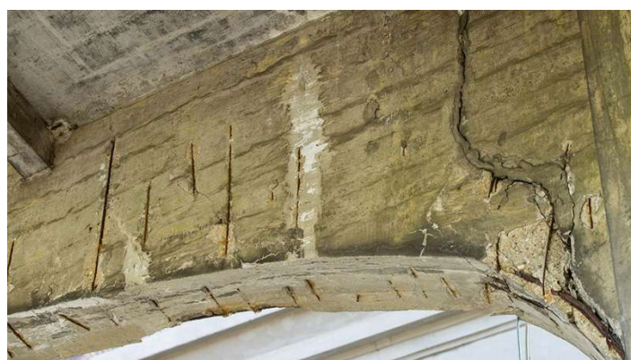
Figure I.6 : Apparition de fissures sur le parement extérieur [9]
