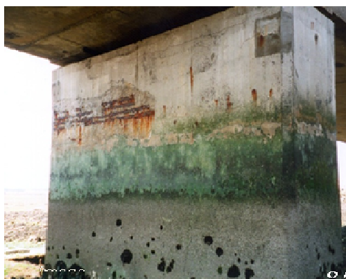
Figure I.5 : Ouvrage en béton armé affecté par la corrosion [8]
