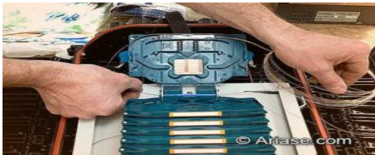
Figure 55: (2.34): Point d'éclatement GPON: Cassettes d'épissure.
