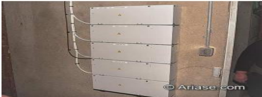
Figure 59: (2.38): Point de mutualisation dans le sous-sol d'un immeuble (cas des zones très denses).
