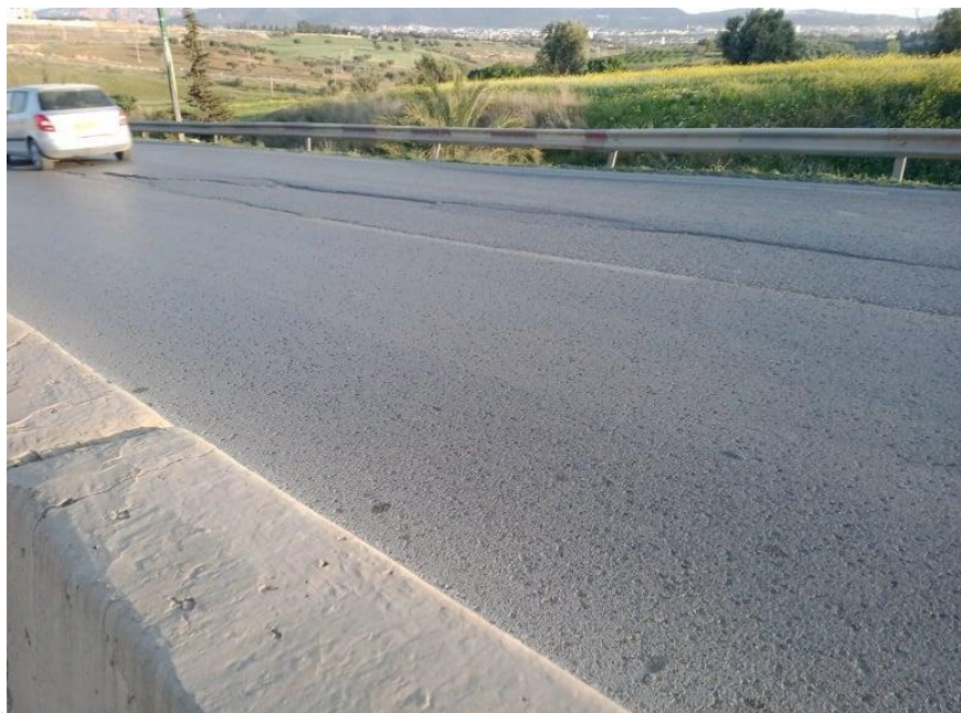
Figure II.18) déformation longitudinale -orniérage-(photo de notre expertise prise le 05/04/2021)
