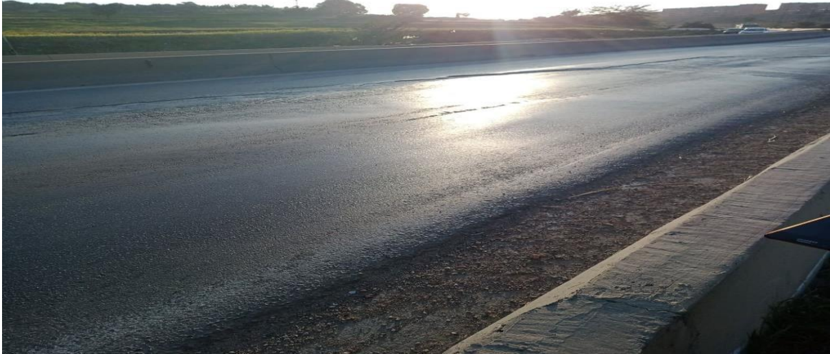
Figure II.19) déformation longitudinale –un affaissement-(photo de notre expertise le 05/04/2021)
