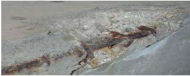
Figure 1.3 : Carbonatation du béton[Made, 2007]
