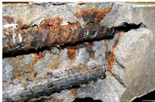
Figure 1.5 : L'accumulation des produits de corrosion et l'éclatement de l'enrobage [technichem.be]
