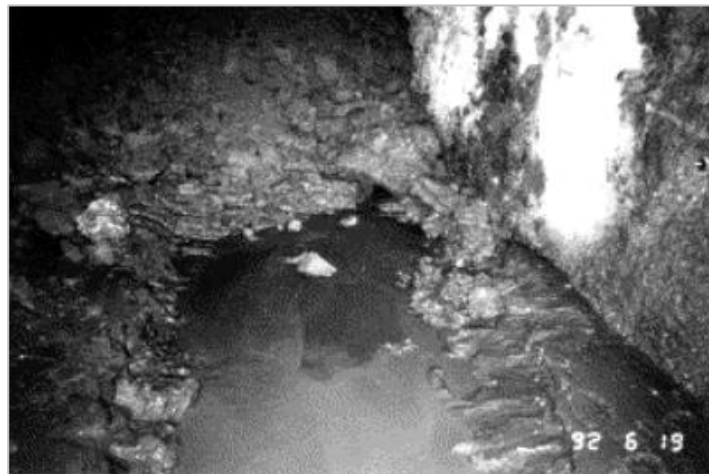
Figure 1.12 Inondation du tunnel de Wushantou, Japon 1992, (Wanget et al., 2002) cité par (Jamal, 2018)
