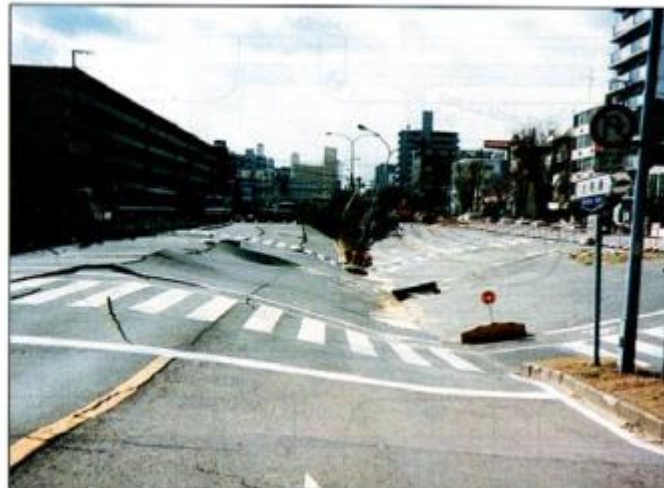
Figure 1.10 Effondrement de la route nationale au-dessus de station de métro de Daikai endommagée par un tremblement de terre (Japon, 1995), (Yoshida et al., 1996) cité par (Jamal, 2018)
