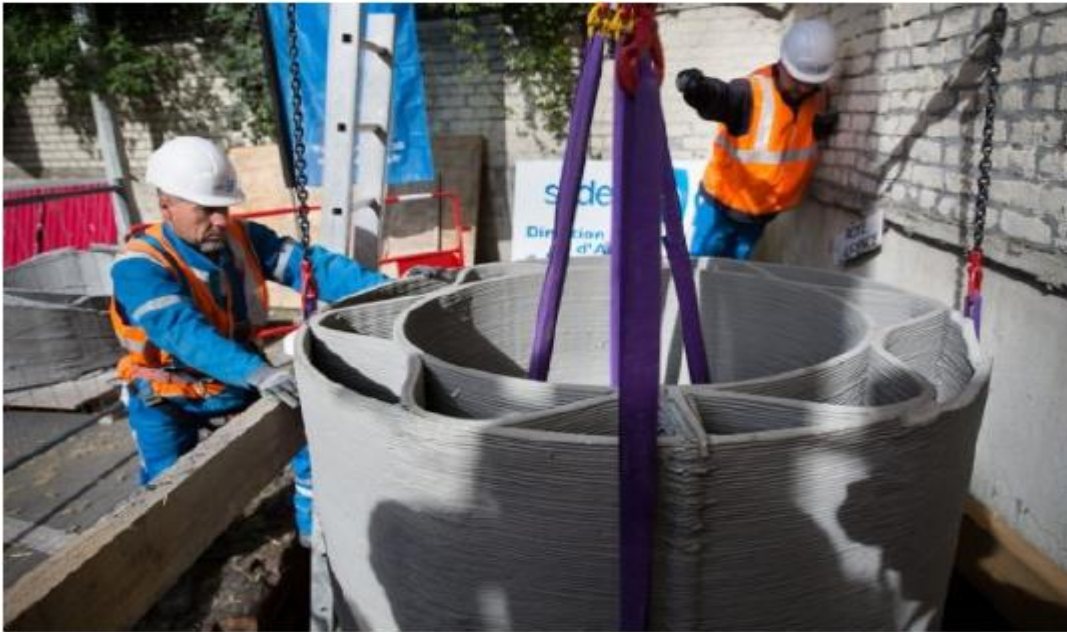
Figure 2.3: Fosse d'inspection souterraine (XtreeE, 2017).
