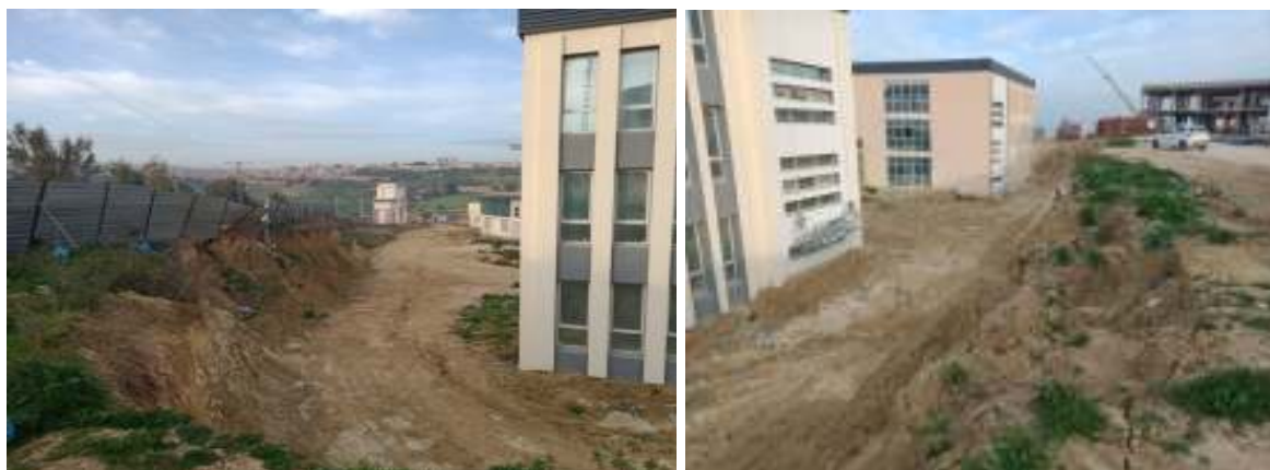
Figure (4.33): Photo du site montrant l'état de dégradation
