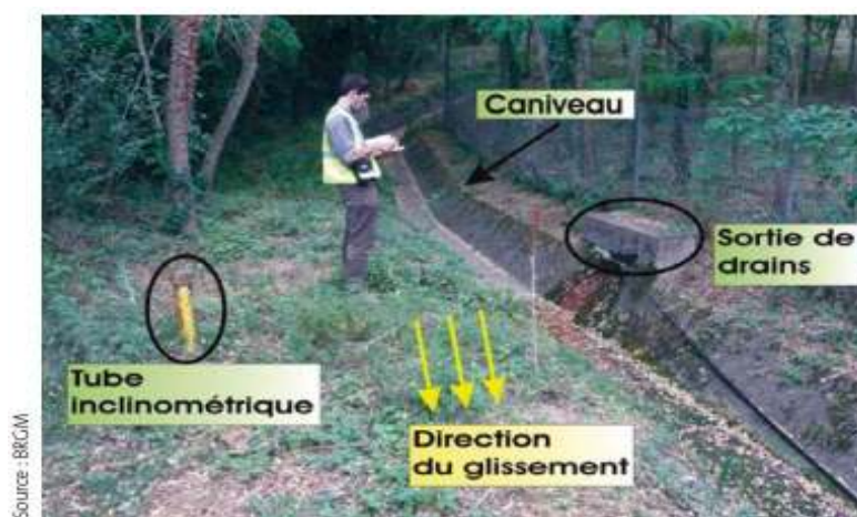
Drainage des eaux de surface à l'aide d'un caniveau (Alpes-Maritimes)
