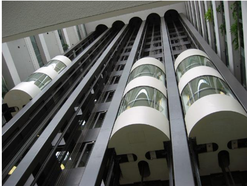
figure 1.32 ascenseur dans un centre commercial
