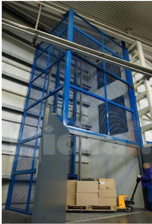
Figure 1.28 ascenseur dans une usine
