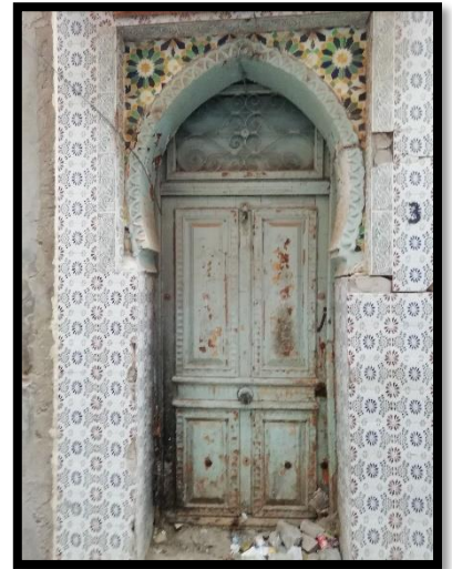
Figure 62: Arc existant dans le quartier Bab Zir
