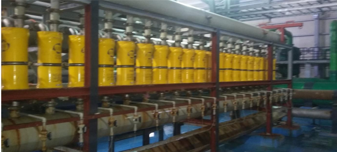
Figure 31: Les récupérateurs d'énergie (ERI) d'un module d'OI de le SDEM
