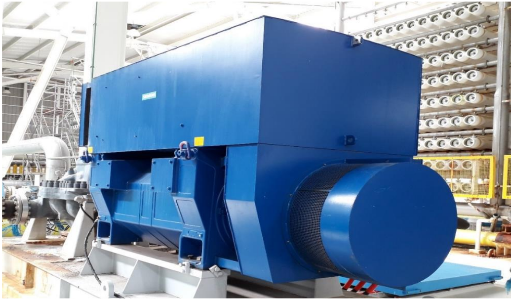
Figure 29: Photo d'une pompe à haute pression
