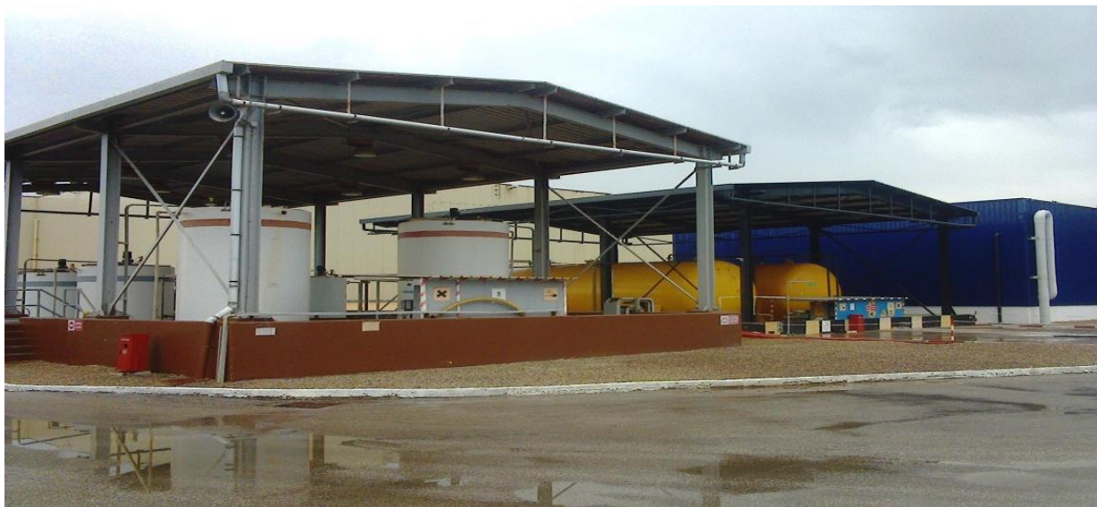
Figure 26: Réservoirs des différents dosages chimiques
