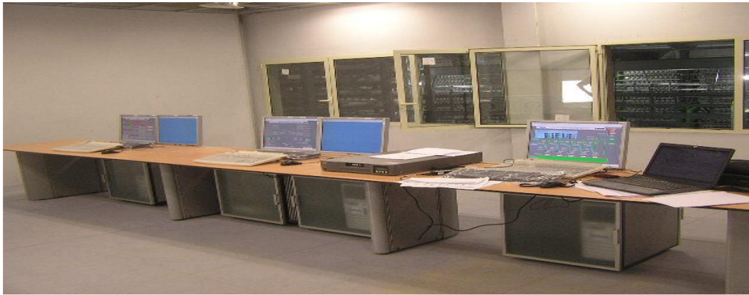
Figure 38: la salle de contrôle de la SDEM Chatt El Hilal
