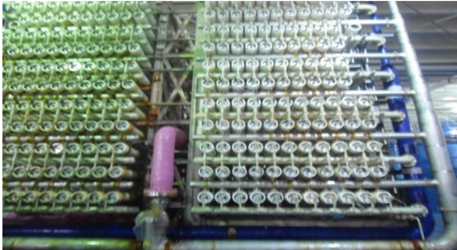
Figure 32: Unité d'osmose inverse
