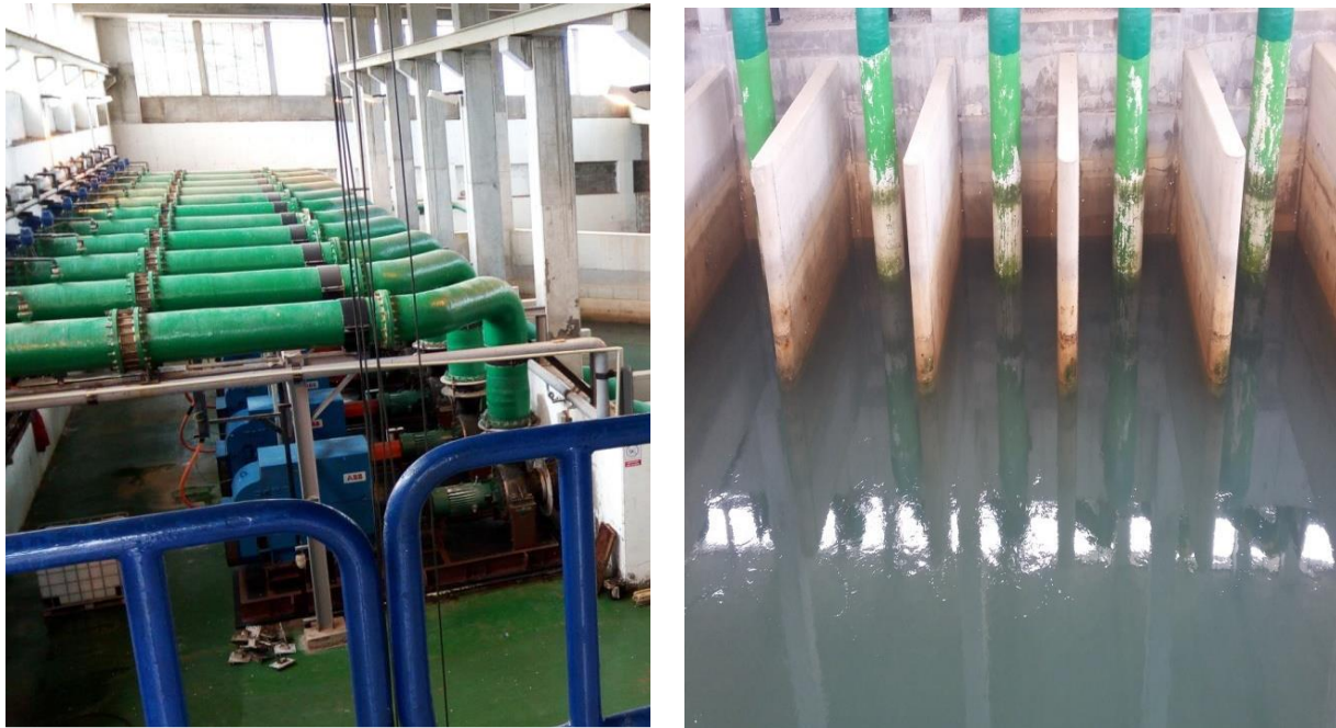
Figure 25: pompes de pompage et bassin de stockage
