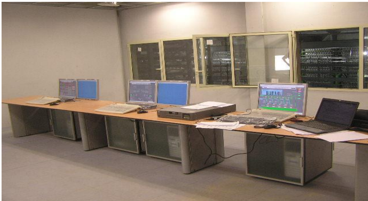
Figure 45: la salle de contrôle de la SDEM de Béni saf [51].
