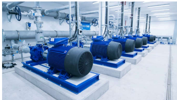
Figure I.0.14: groupe de pompage
