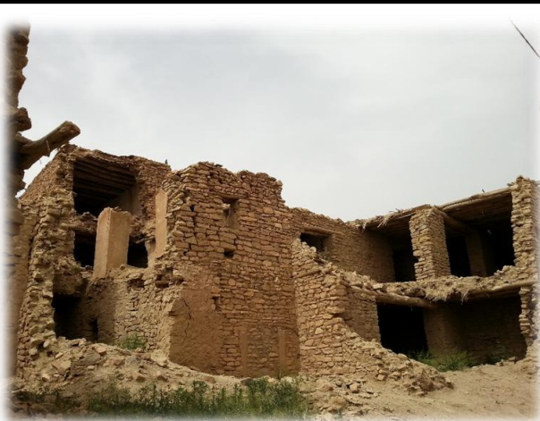
صورة رقم 06: الجزء المهدم للواجهة للمسكن الاول والثاني
