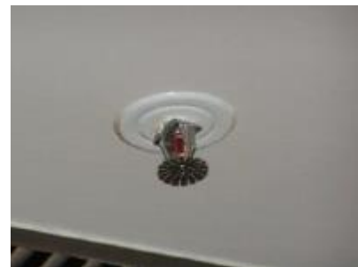
Figure4: 30 : SPRINKLERS ,source :internet
