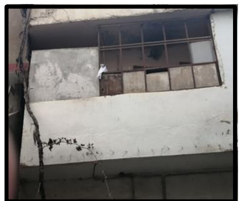
Figure 51: habitat en mauvaise état
