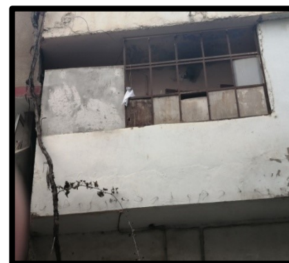
Figure 20: Habitation mauvais état Source : Auteur
