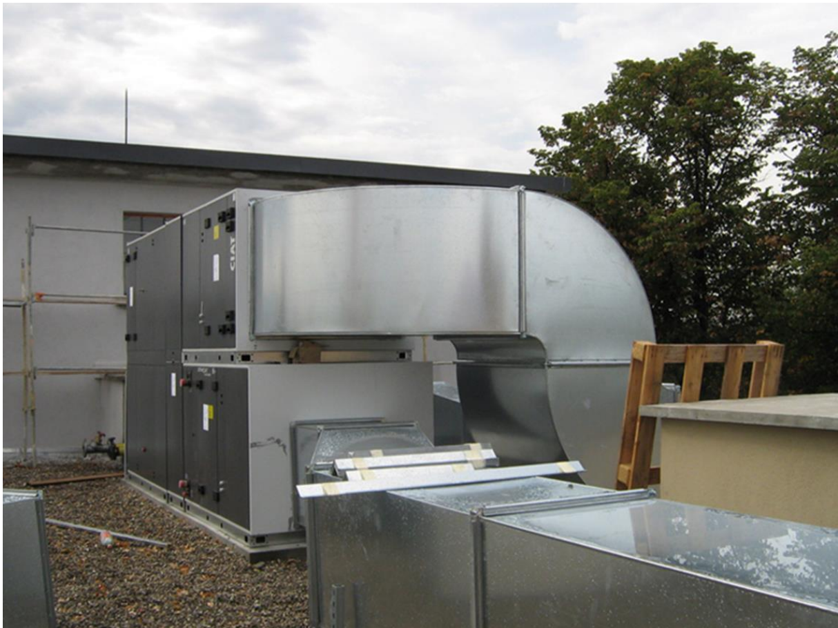
Figure98 : photo d'une centrale de traitement d'air CTA
