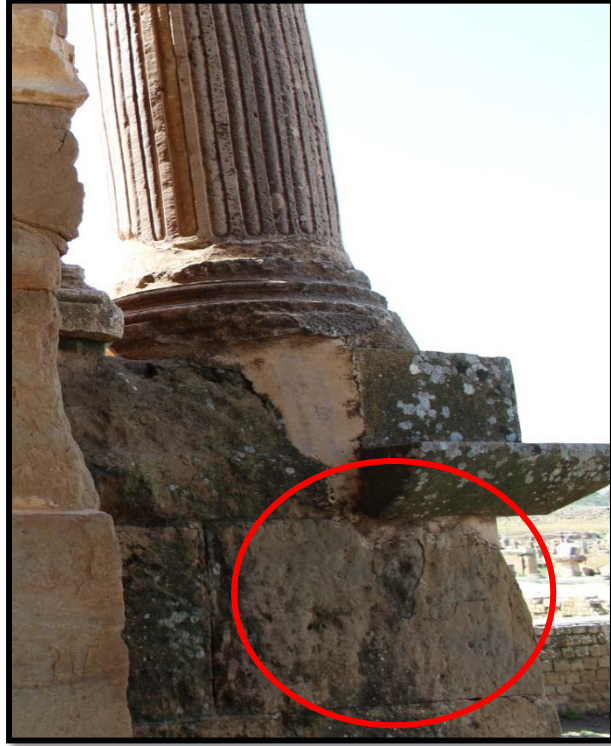
الصورة 38: تقشر حجارة حاملة لأحد الأعمدة الكبيرة بجوار البوابة المركزية
