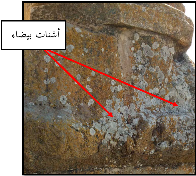
الصورة 24: بقع لأشنيات بيضاء
