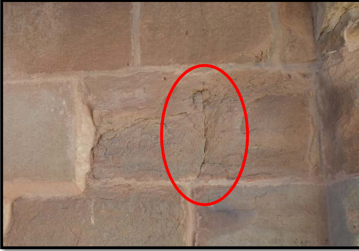
الصورة 32: كسور في الجزء العلوي للجدار الداخلي للبوابة المركزية
