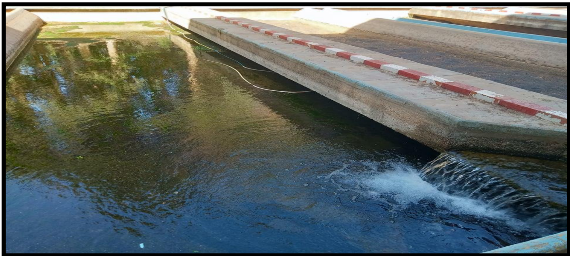
Figure III.3 : Bassin de filtration de la station de Lalla Setti 2.
