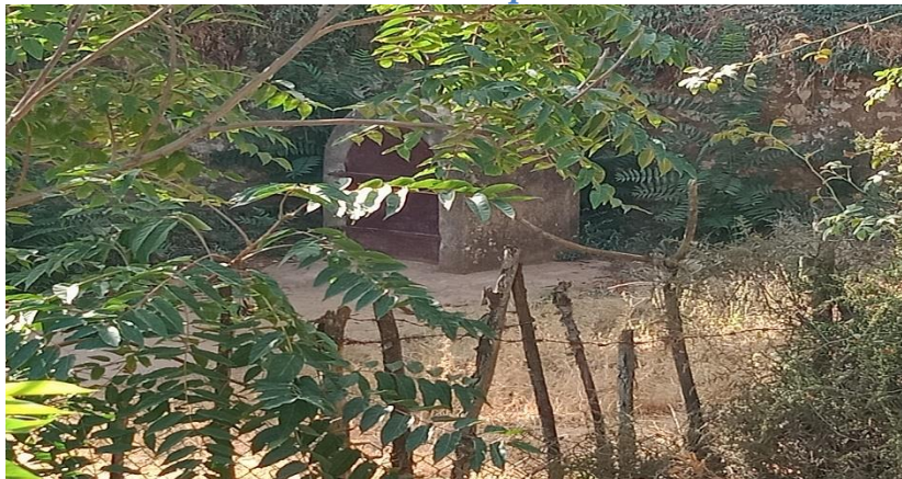
Figure IV.3 : l'état du grillage associé au PPI existant.
