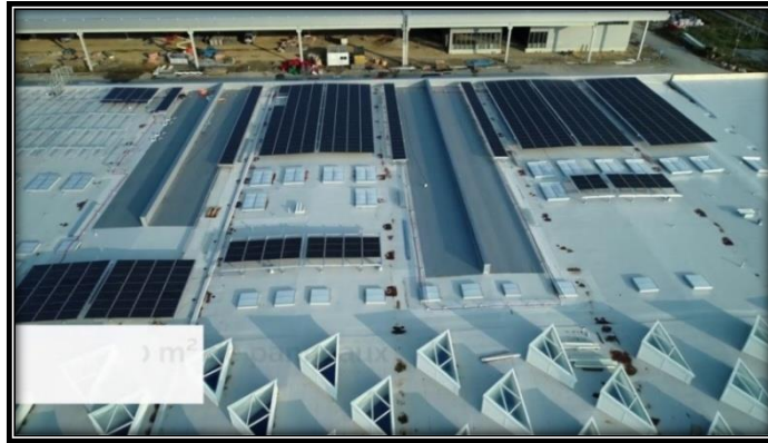
Figure 54: Les panneaux photovoltaïques
