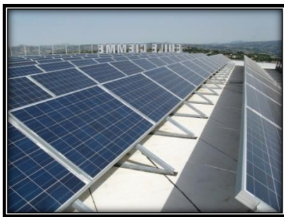
Figure 195: Panneaux solaire hybrides dans une terrasse plate
