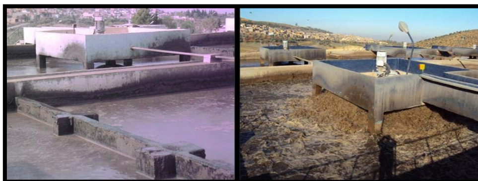
Figure IV.8 : Les bassins d'aérations
