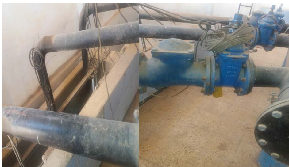
Figure V.2 : Photos de la station de relevage de Chetouane .
