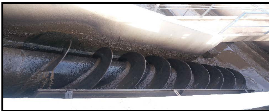
Figure IV.19 : Vis de recirculation de la STEP.
