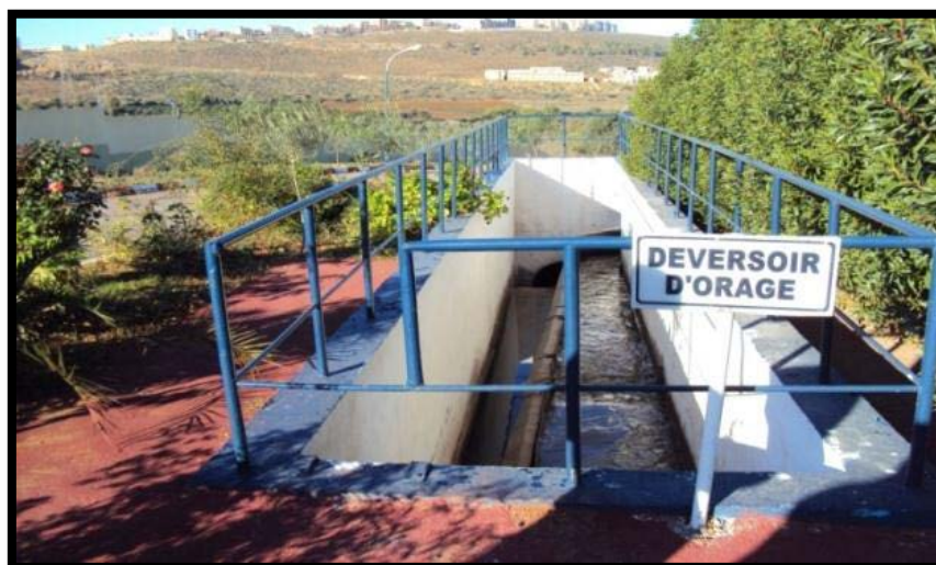
Figure IV.2 : Le déversoir d'orage.
