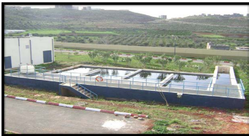
Figure IV.12 : Bassin de chloration.
