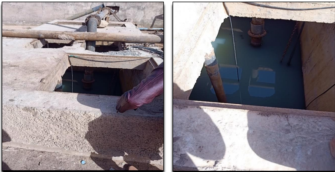
Figure 15 : La station de relevage de la localité d'El Barka [12].
