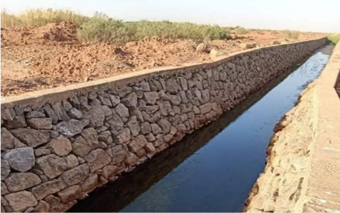
Figure 13 : Photo du canal de drainage d'In Salah [12].
