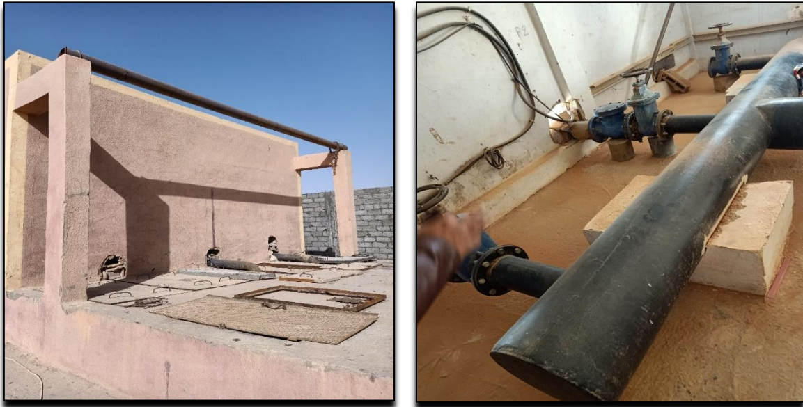
Figure 14 : La station de relevage d'In Salah [12].
