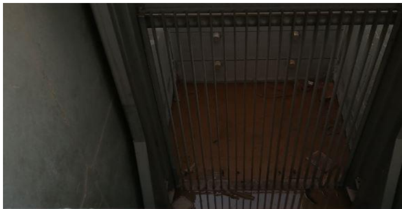
Figure 25 : Dégrilleur mécanique droit (photo prise dans la STEP de Timmimoun).
