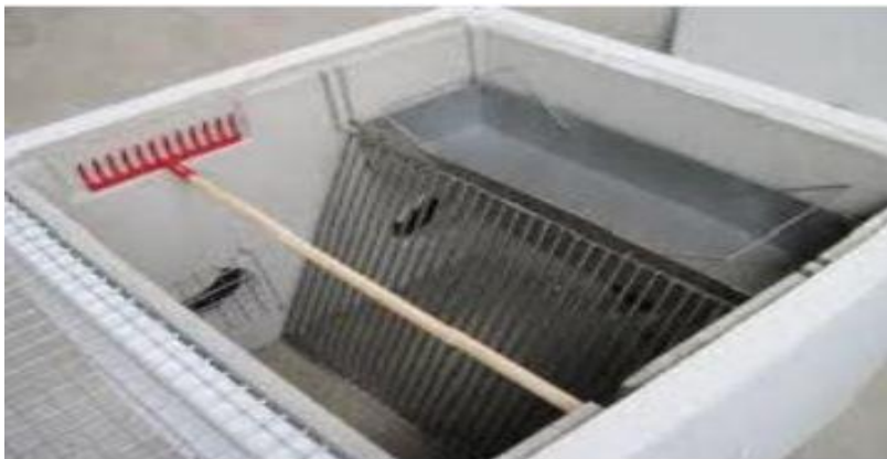
Figure 24 : Un dégrilleur manuel avec un râteau [13].
