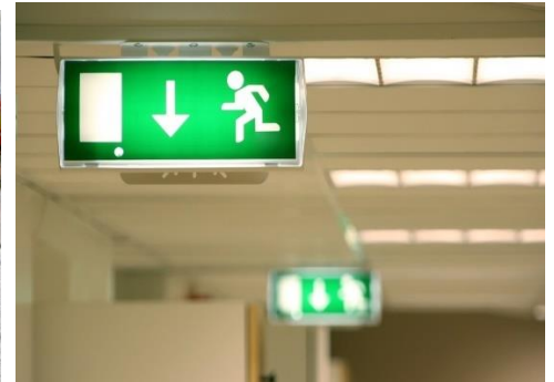
Figure : Signalisation lumineuse des issues de secours
