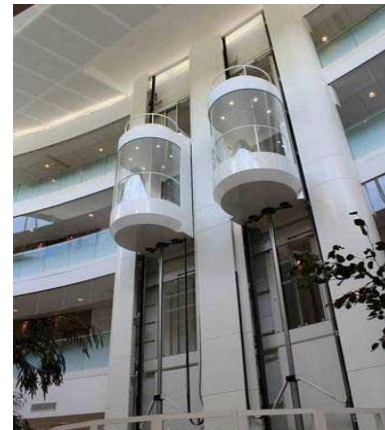
Figure : Ascenseurs panoramiques
