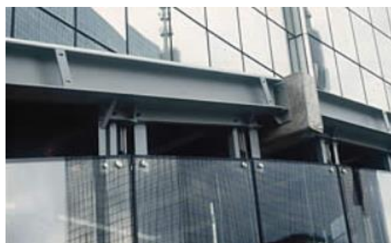
Figure : on voit les joints et les lames d'aires au MRVS
