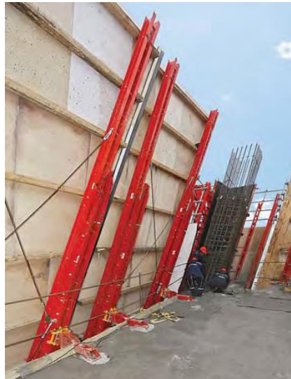
Figure 51 : Panneau de protection RCS positionné incliné
