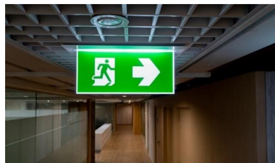
Figure : Eclairage de sécurité
