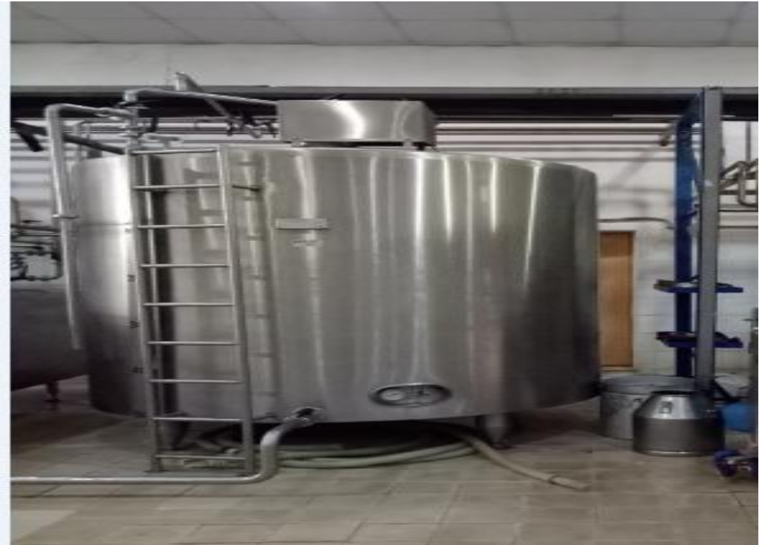
Figure 8 : Cuve de stockage lait pasteurisé
