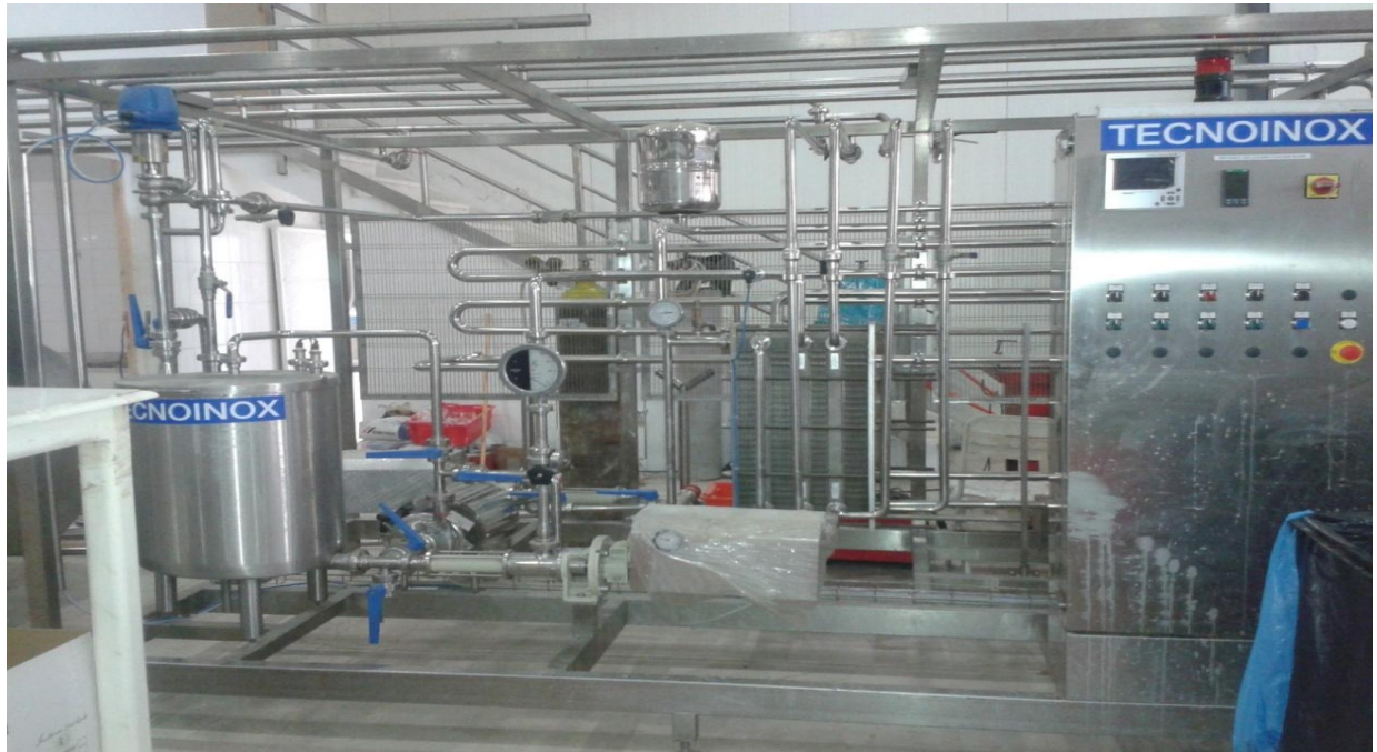
Figure 7 : Machine pasteurisation lait
