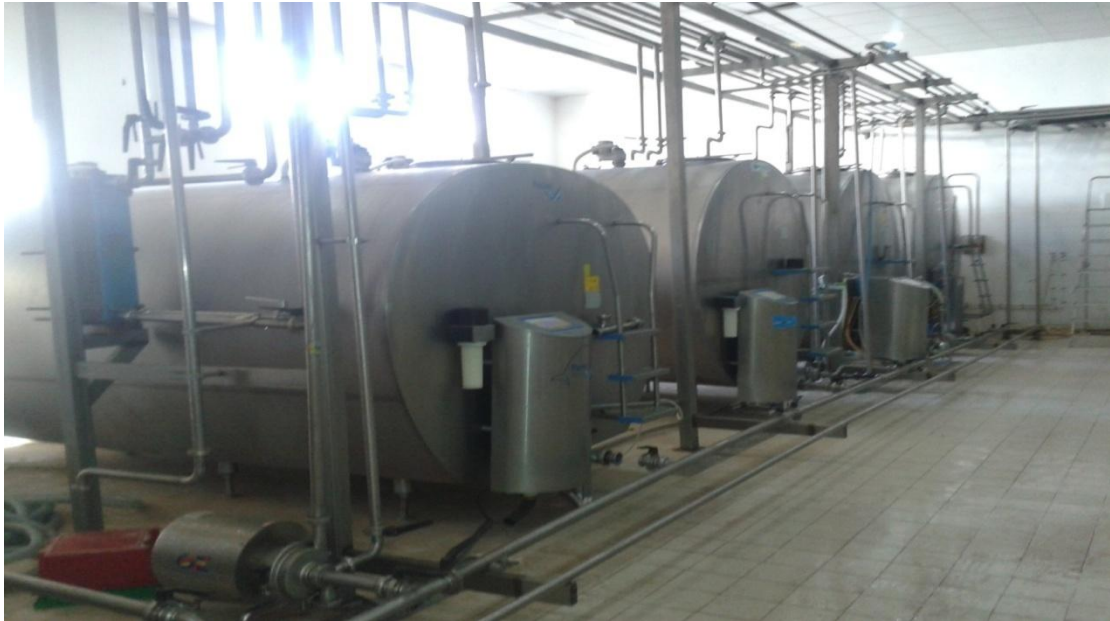
Figure 4 : Cuve de stockage lait
