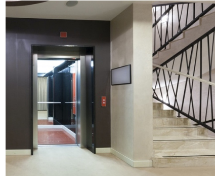
Figure 157 Exemple d'un ascenseur
