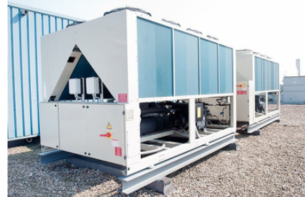
Figure 150 Exemple de climatisation et chaufferie
