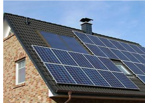
Figure 10 Panneaux Solaires Photovoltaïques
