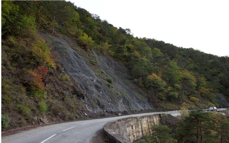
Figure 1.33 : Stabilisation des talus par grillage (Belloir & Nuzillard, 2009)
