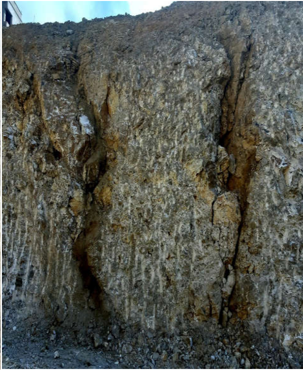
Figure 2.15 :.Risque probable Affaissement rocheux (calcaire)
