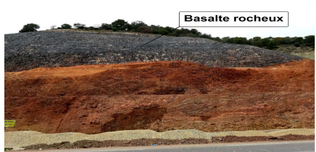
Figure 2.18 : Chutes des blocs (basalte rocheux)
