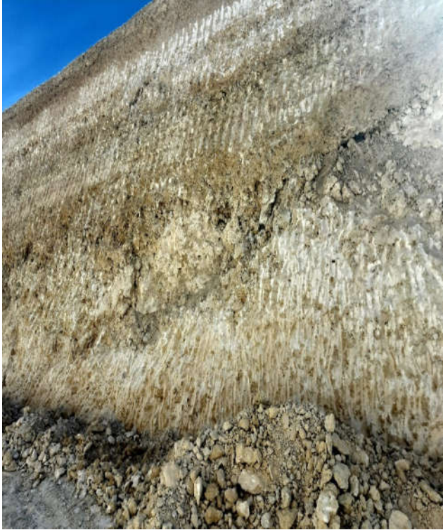
Figure 2.14 :.Risque probable Chutes des blocs (formation calcaire)
