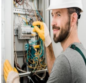
Photo 67. La maintenance électrique.
