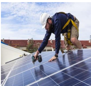
Photo 66. L'entretien des panneaux photovoltaïques.
