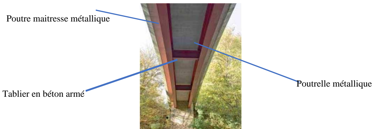
Figure 166 : Vue de dessous des bipoutres de la passerelle mixte à Wasserbillig, Luxembourg, source 84
