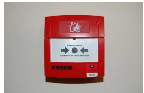
Figure 165 : système d'alarme contre incendie source : http://www.atnsecurite.fr/bourges/12/alarme-incendie-professionnels-bourges-cher.html
