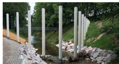
Figure 173 : Protection contre les crues, peigne de retenue des bois flottants, Birsig , source : https://www.csd.ch/fr/prestations/amenagement-de-cours-deau-et-hydrolique
