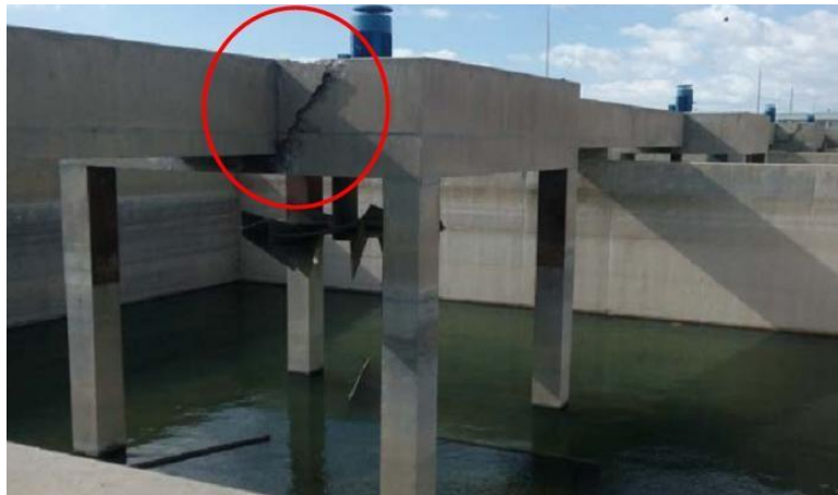
Figure IV.5 : Infrastructure du bassin d'aération (04/2014)
