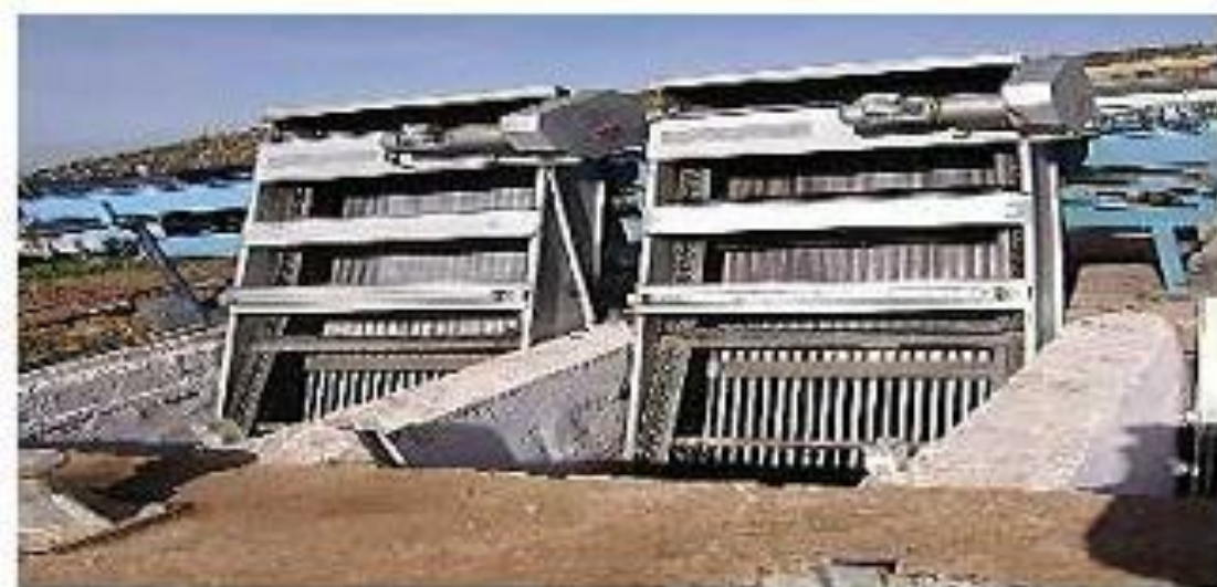
Figure II.22. Grille mécanisée (Ain El Houtz)
