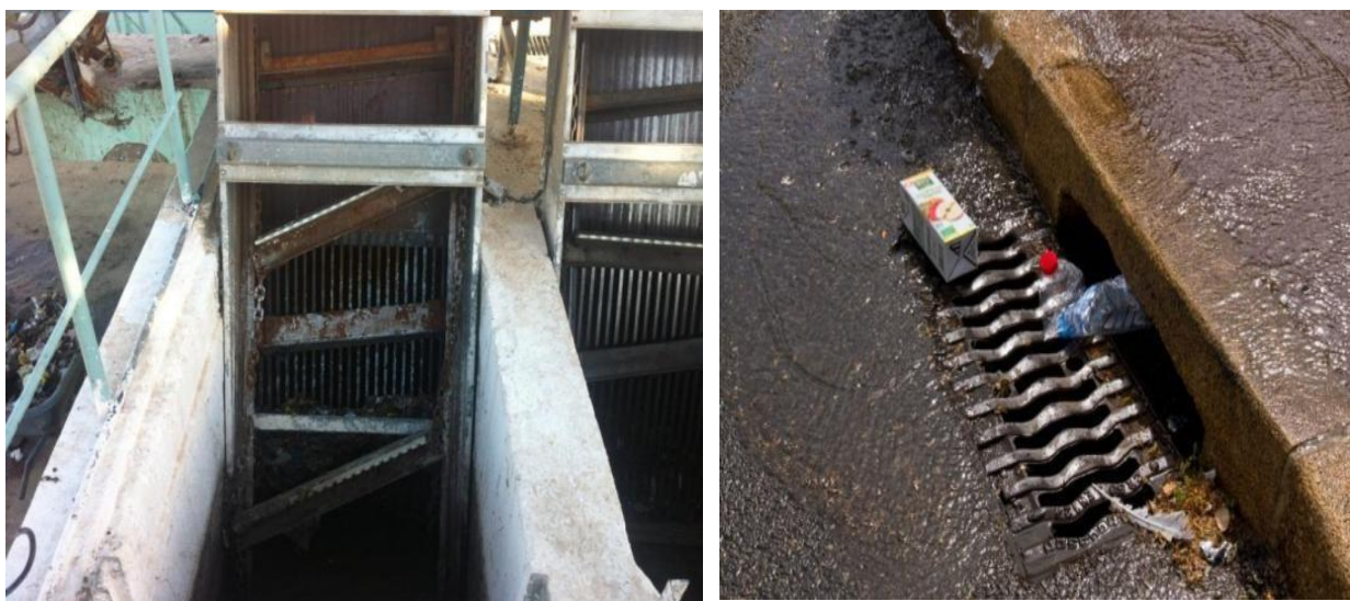
Figure IV.2 : panne mécanique au niveau dégrilleur (24/06/2014)
