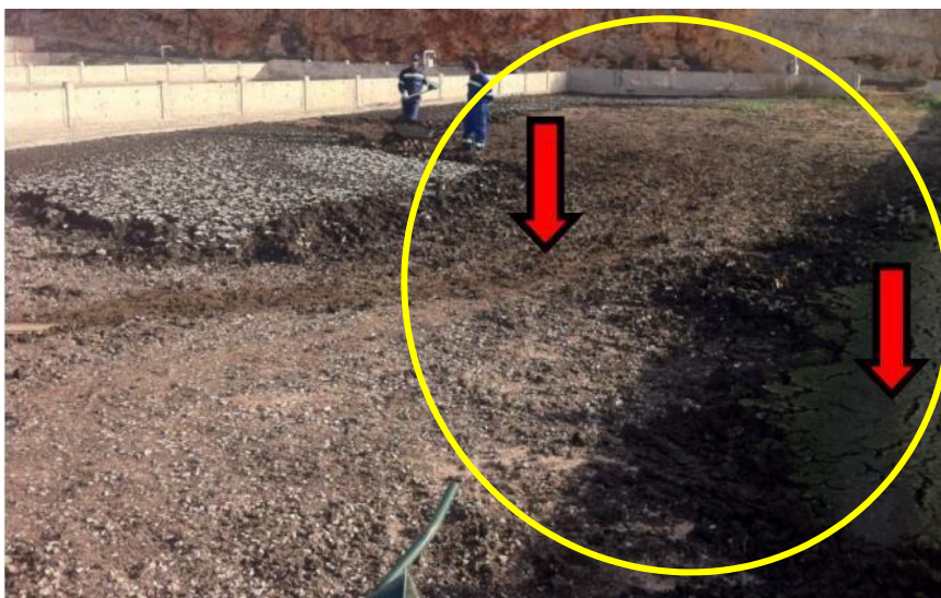
Figure IV.4 : Lit de séchage détérioré
