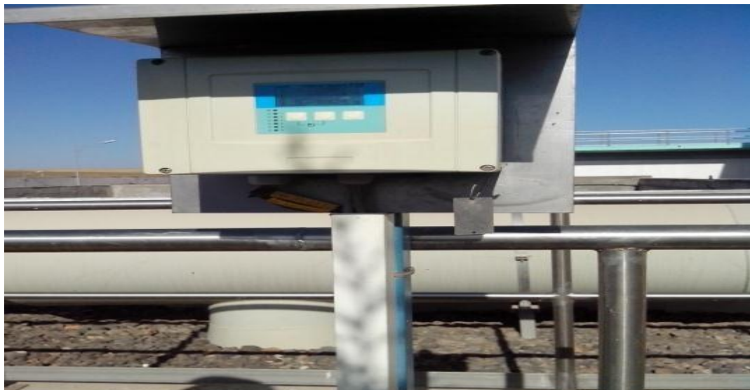
Figure II.10. Débitmètre à ultrason (Terga)
