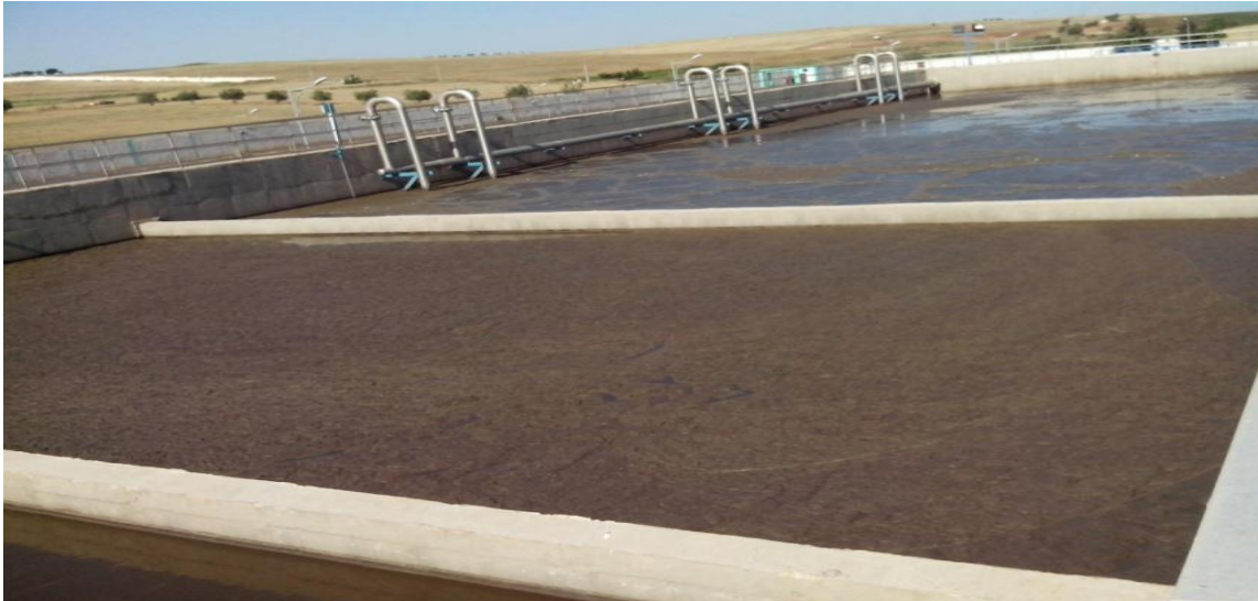
Figure II.13. Bassin d'aération (Terga)
