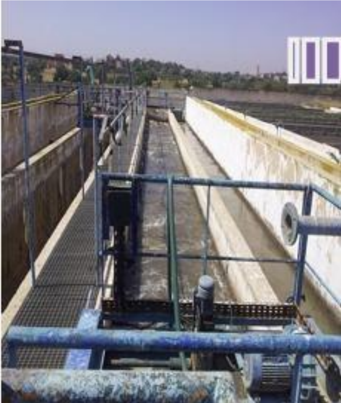
Figure II.35. Dessableur-déshuileur (Ain Bouchakif)
