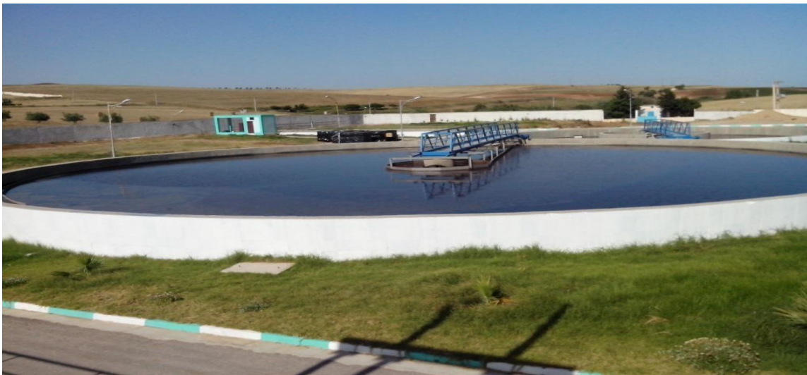
Figure II.14. Décanteur secondaire (Terga)
