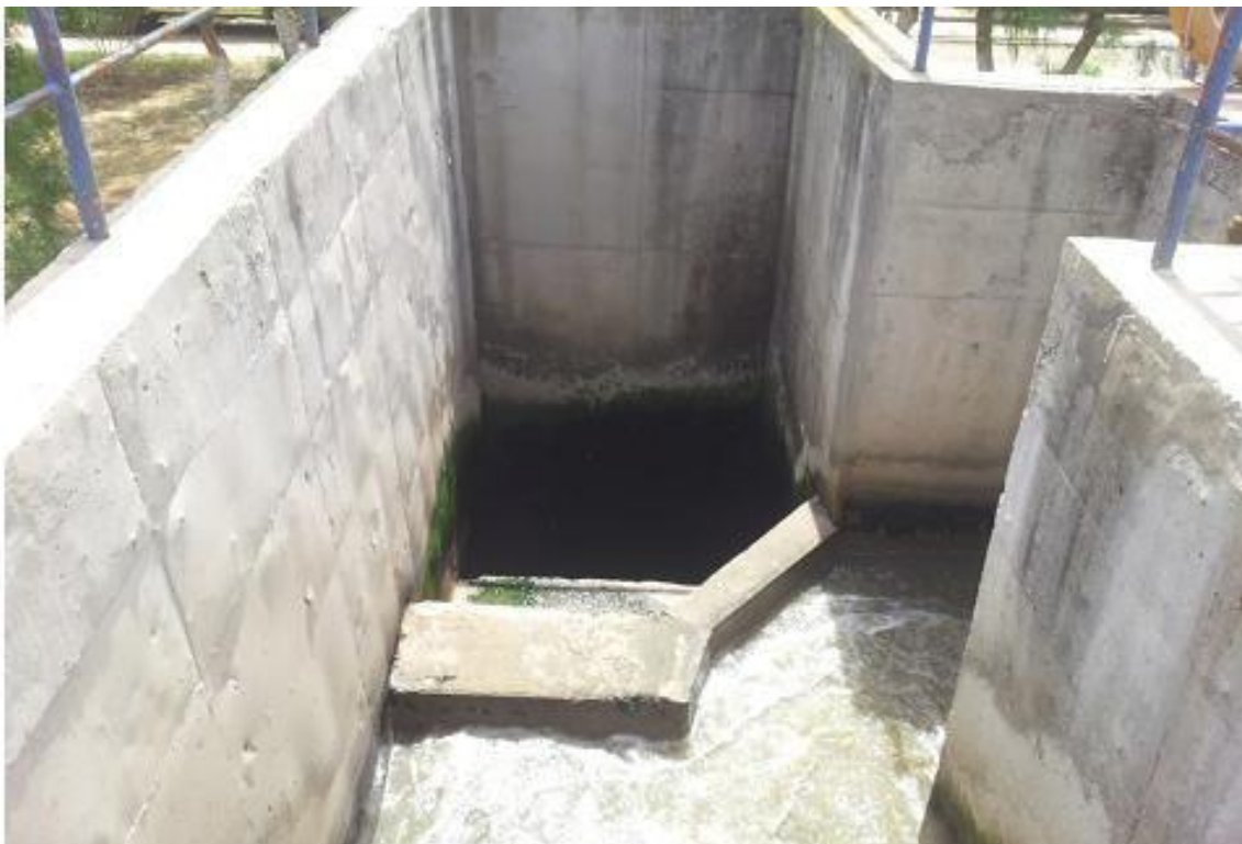
Figure II.30. Déversoir d'orage (Ain Bouchekif)
