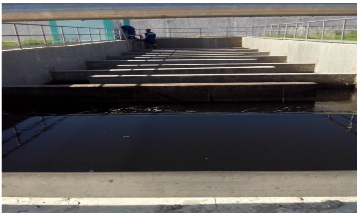
Figure II.16. Bassin de désinfection (Terga)
