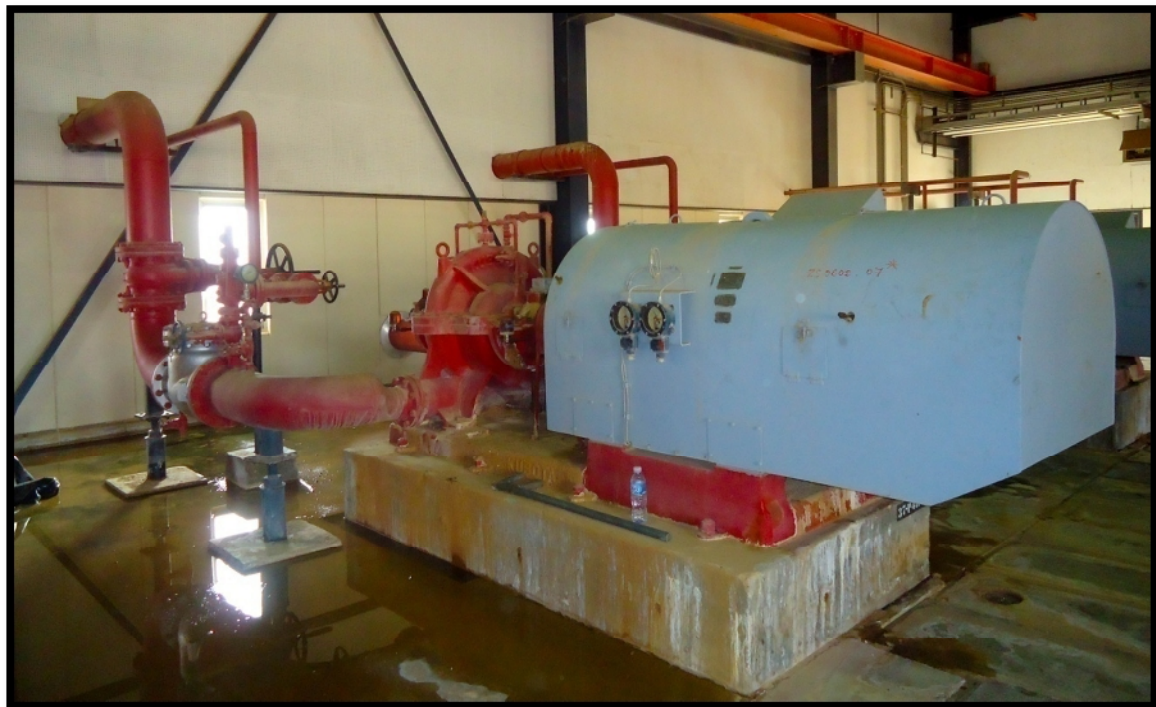
Figure IV.1: Pompe anti-incendie P411A entraînées par moteur électrique
