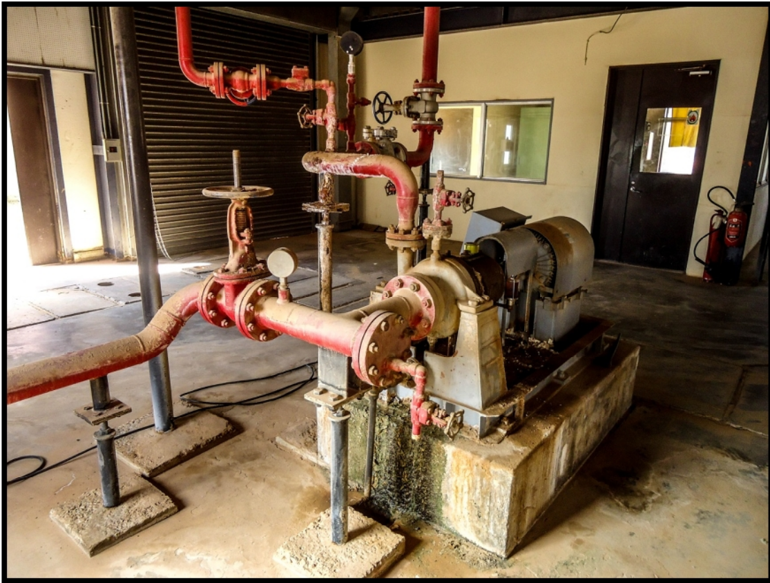
Figure IV.2: Pompe anti-incendie P412A dite aussi pompe « Jockey »
