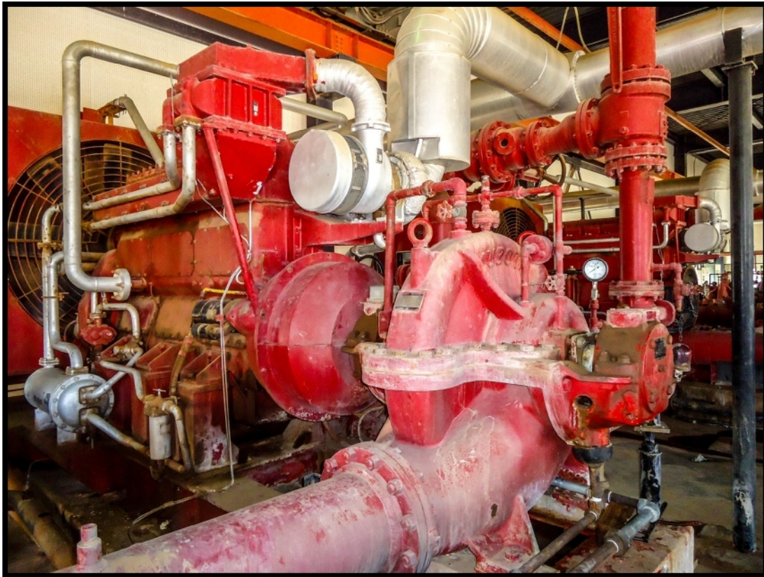
Figure IV.3: Pompe anti-incendie P411C entraînées par un moteur diesel
