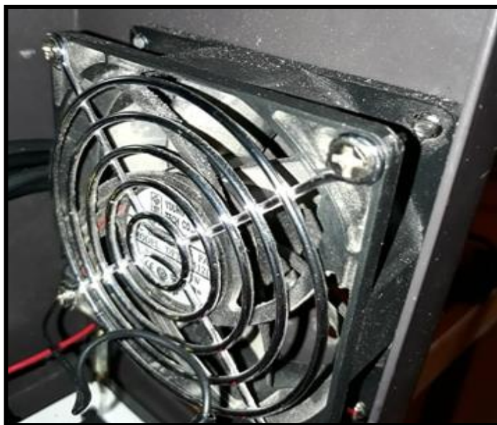
Figure 4.21 Ventilateur montée sur le bati
