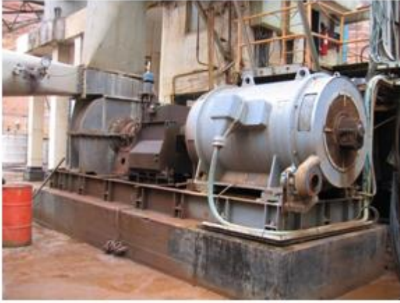
Ancien ventilateur K102
