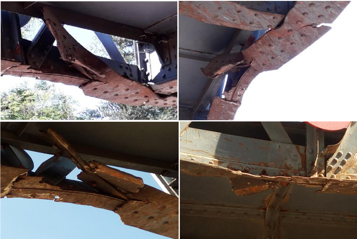
Photo.3.7 Semelle de la membrure inférieure du 5 eme panneau vu de différents angles.
