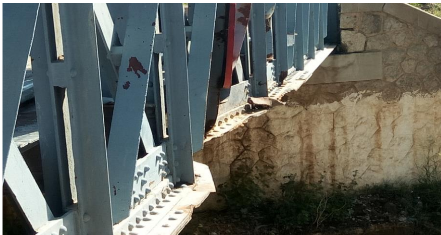
Photo.3.6 Etat de la poutre principale coté SEBDOU.
