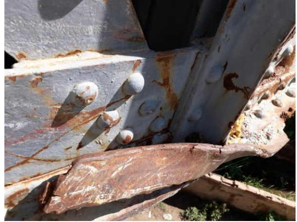
Photo.3.9 Semelle inférieure du 6em panneau (coté SEBDU) vu d'en haut.
