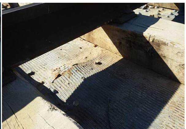
Photo.3.27 Tôle striée déformée du tablier.
