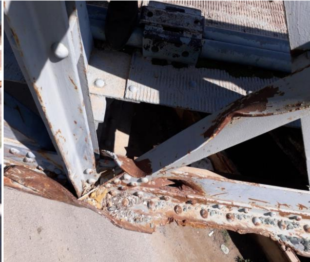
Photo.3.17 Cornière extérieure 7eme panneau.
