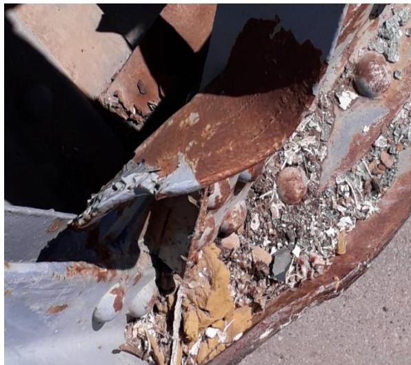
Photo.3.18 Aile de cornière déformée.
