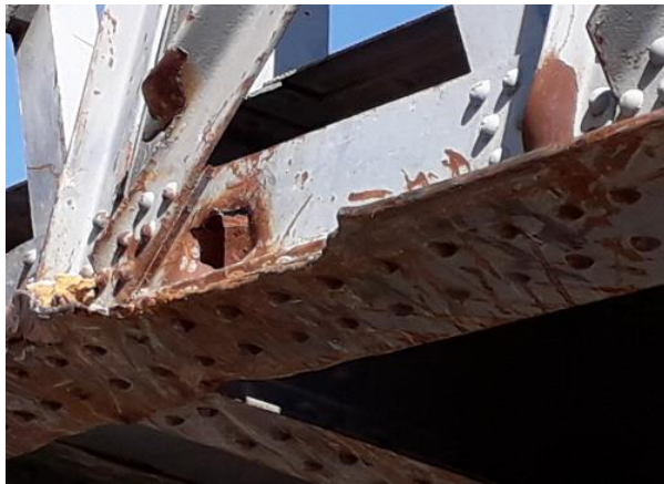
Photo.3.11 Trou au niveau de l'ame.
