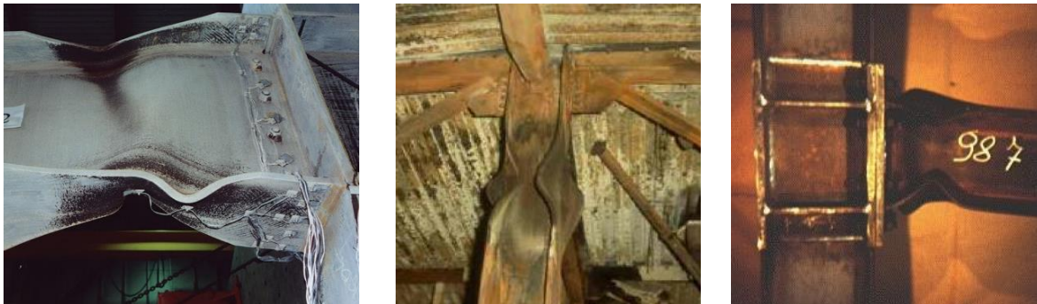
Figure 1.14 : Quelques photos réelles des rotules plastiques
