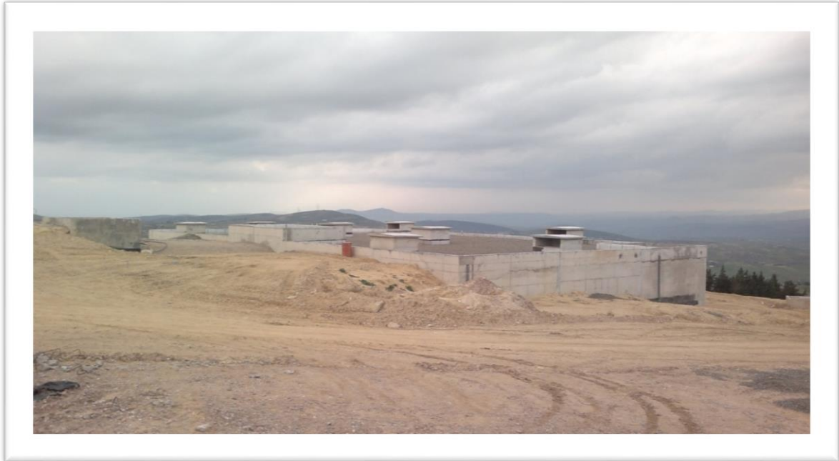
Photo II.5 Réservoir de SOUK LKHEMISS RT1 [31]
