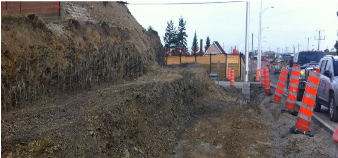
Figure 1.10 Les déblais ou les excavations à la base du talus (Rhône, France).
