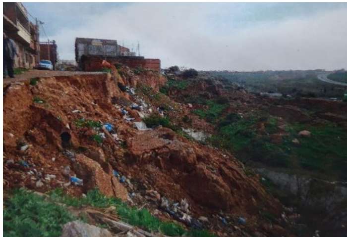
Figure 4.5 Désordre du talus affecté par le glissement [38].
