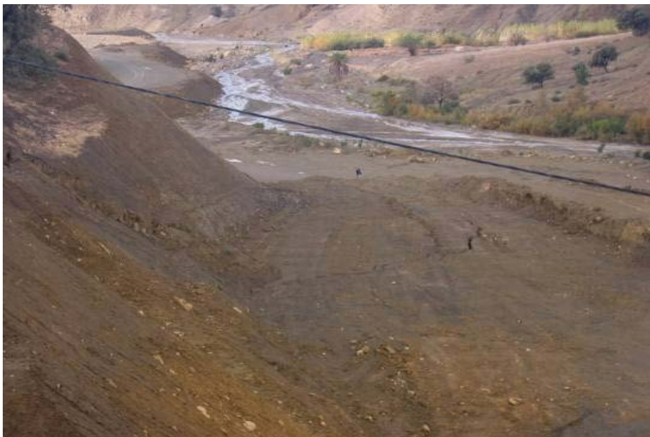
Photo IV.02 : Apparition des fissures au niveau de la plate-forme effectuée au pied de la rive gauche pour la réalisation de l'évacuateur des crues. [25]
