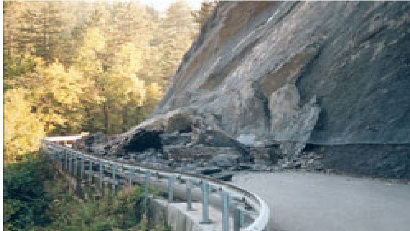
Photo II.02 : Chutes de blocs sur la RD 526 entre Mens et Clelles (Isère) Septembre 2001 [10]
