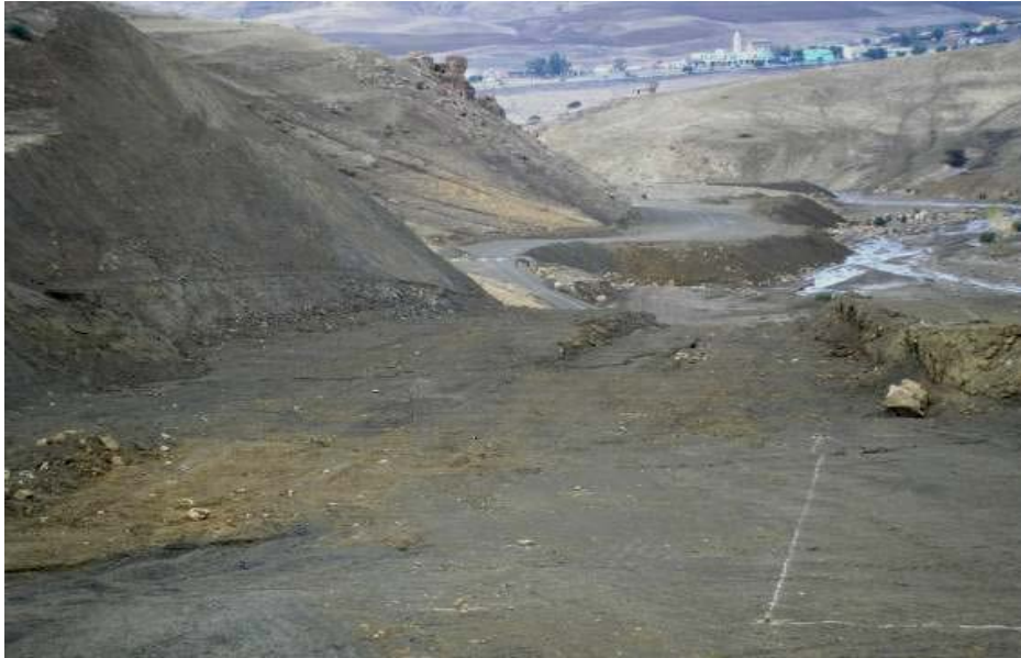
Photo IV.01: Terrassements effectuées au pied de la rive gauche du barrage pour évacuateur des crues. [25]
