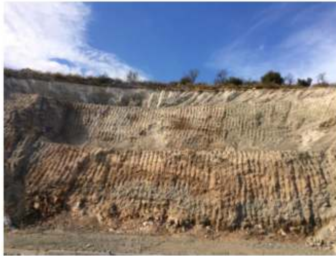
Figure 1-2 Glissement de terrain (Ghazaouet ; 2016)
