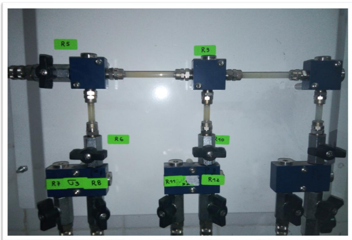
Figure3.12: tableau de contrôle des vannes
