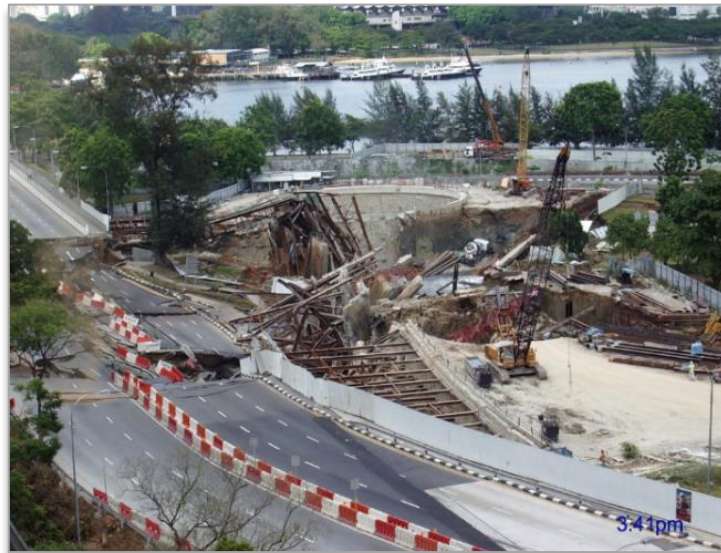
Figure 1.12 Vue d'ensemble de l'effondrement de Nicoll Highway (Singapour) (Gouw, 2011)
