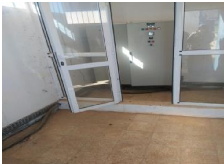
PhotoIV.5 : L'armoire de commande de forage B2
