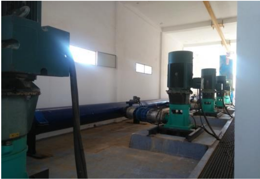
Photo III.1 : La station de pompage Zouia 2.
