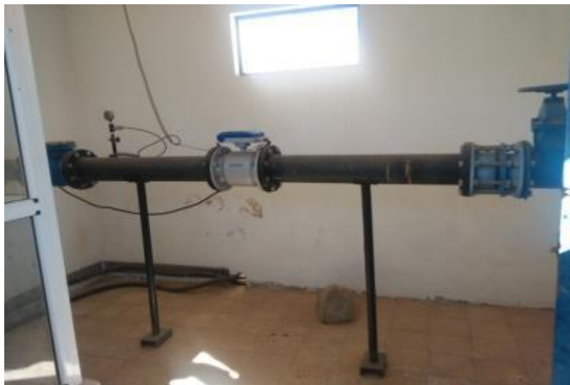
PhotoIV.4 : L'équipement hydraulique de forage B2.
