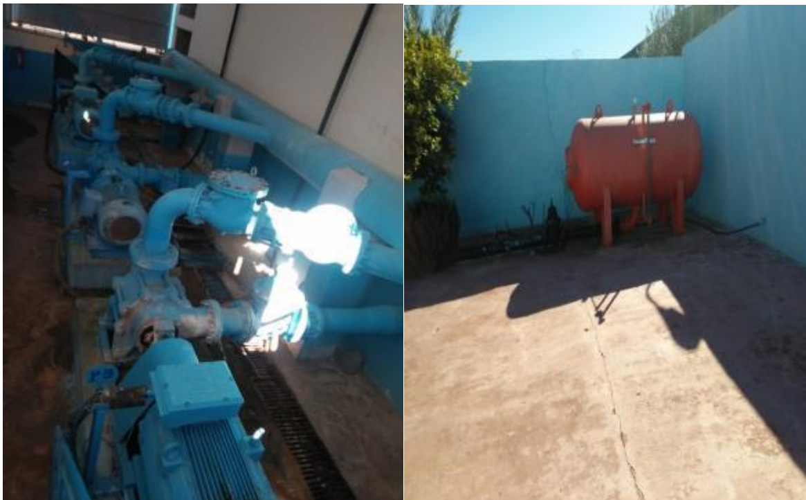
Photo III.2: La station de pompage Zouia 1 et l'anti-bélier.
