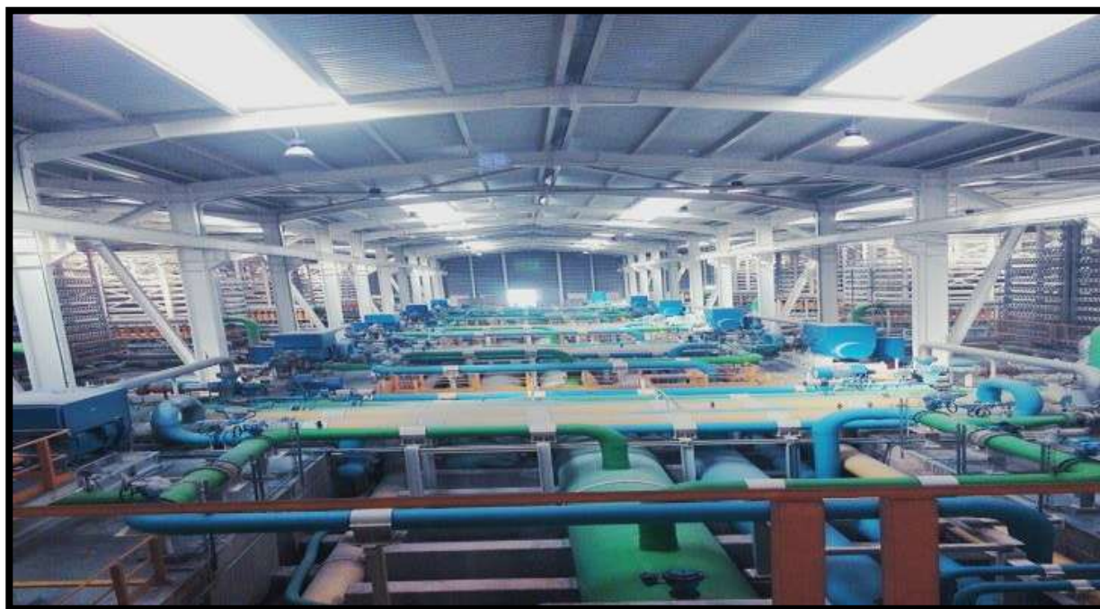
Figure II.4 : Station de dessalement de Honaine [24].
